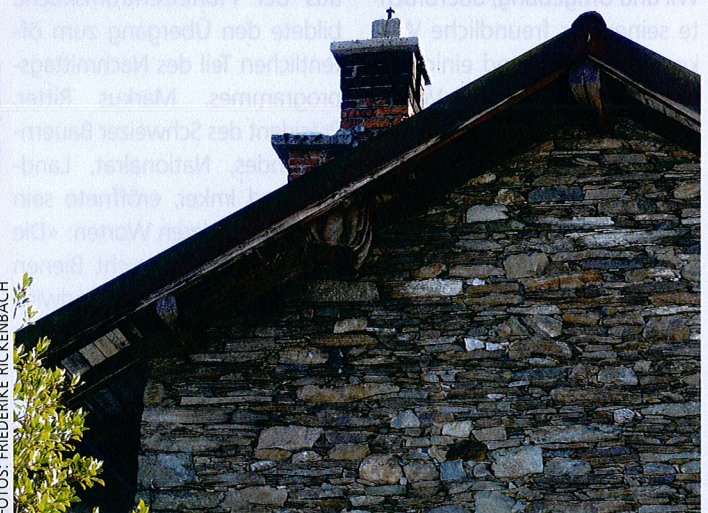
Auf der Höhe des Kamins ist unter dem Dachvorsprung der Wabenbau eines Bienennestes zu erkennen.
